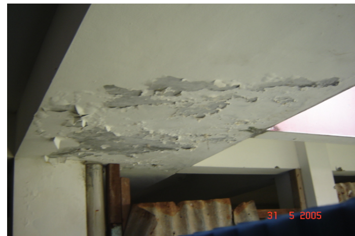
Kondisi dinding di RS. Z (tipe D)
